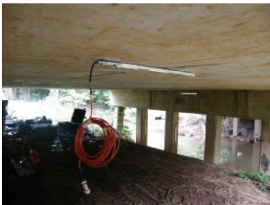
การติดตั้งอุปกรณ์วัดความเครียด Strain Transducer
