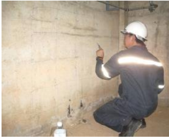
การระบุตำแหน่งทดสอบ Corrosion
