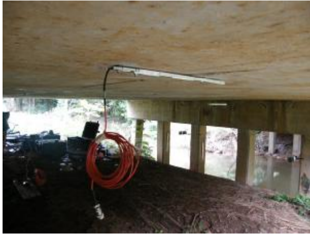
รูปที่ 2 การติดตั้งอุปกรณ์วัดความเครียด Strain Transducer
