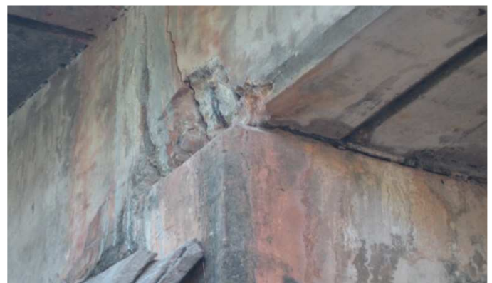
ภาพที่ 3 รอยแตกร้าวที่ฐานรองรับแผ่นพื้นสะพาน
